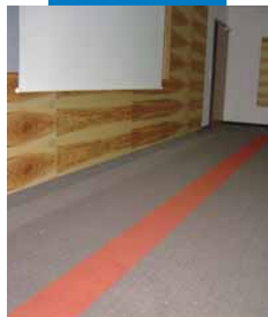
Esempio di utilizzo di Primer G prima della stesura di Ultraplan Eco e dell'adesivo Rollcoll per l'incollaggio della moquette nelle stanze dell'albergo - Villa Hotel Castellani - Austria
